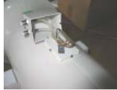
動圧測定用ピトー管接続部 損傷・変形なし。
