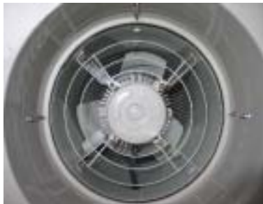
ファン・羽根 損傷・変形なし。回転もスムーズ。
